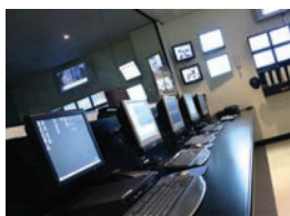
Centrales receptoras de alarmas
